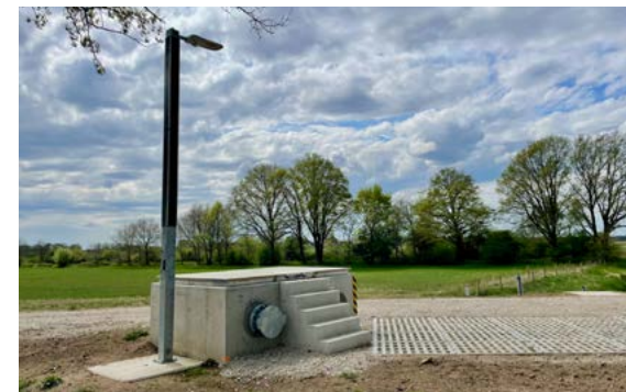
Figuur 137. Referentiefoto pompopstellocatie Neer, als optelsom van technische eisen zonder ruimtelijke inpassing, welke op de continuïteit en het beeld van de waterkering onderbreekt; bron: Waterschap Limburg
