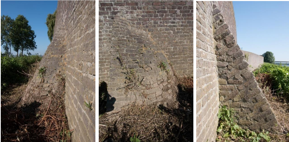
Sectie drie, de linker steunbeer in zijaanzicht (vanuit oost), vooraanzicht en zijaanzicht (vanuit west).
