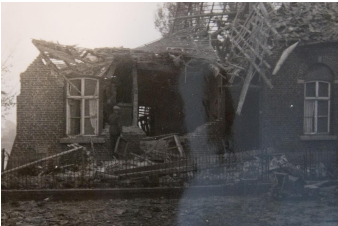
Schade aan het kerkhuis (voormalige schoolgebouw).
