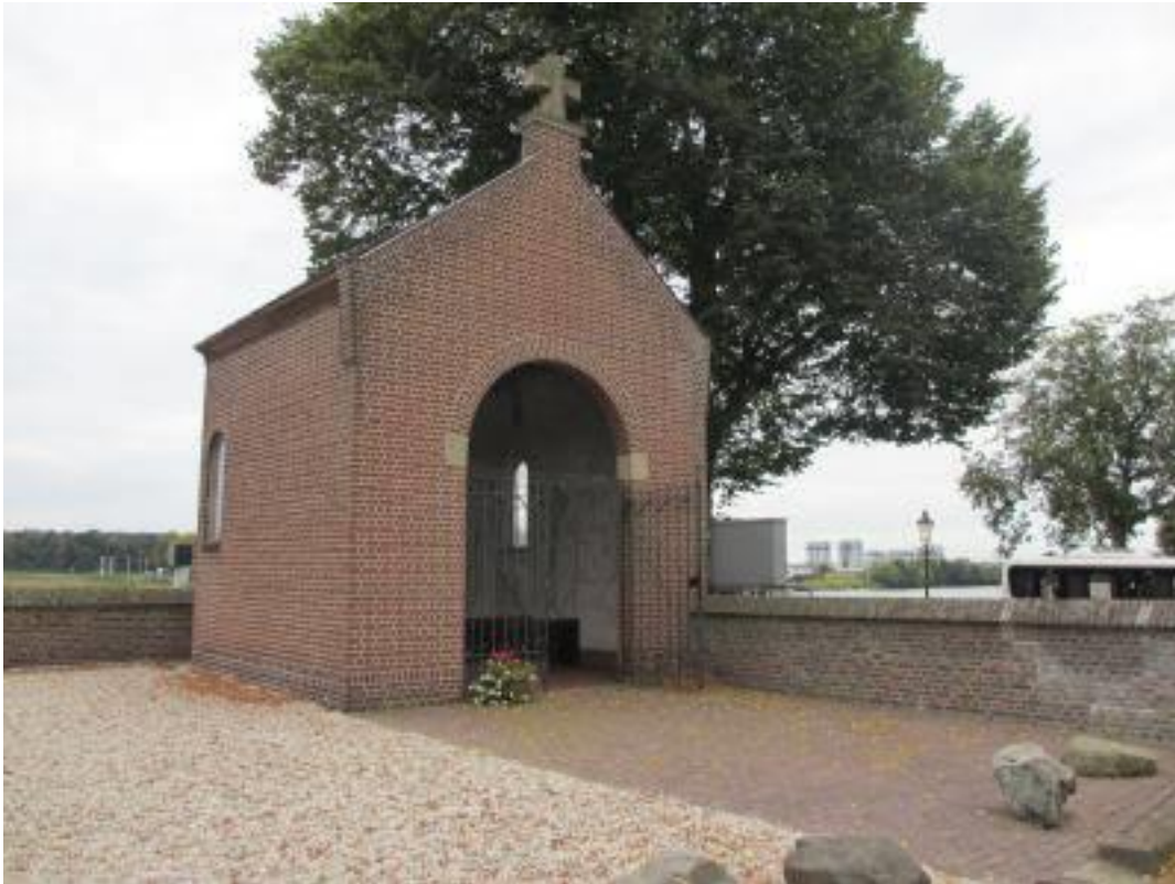
Muur langs de kapel. De herstelling tekent zich op deze foto nog vrij duidelijk af (witte zoutuitslag).
