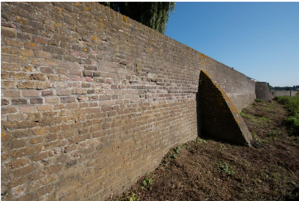
Deel van de muur, waarin ten minste twee min of meer horizontale bouwnaden zijn te ontdekken. Nabij de steunbeer is vrij goed te zien dat het onderste deel van de muur uitbuikt.
