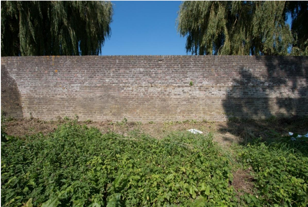
Deel van de muur, waarin ten minste twee min of meer horizontale bouwnaden zijn te ontdekken.
