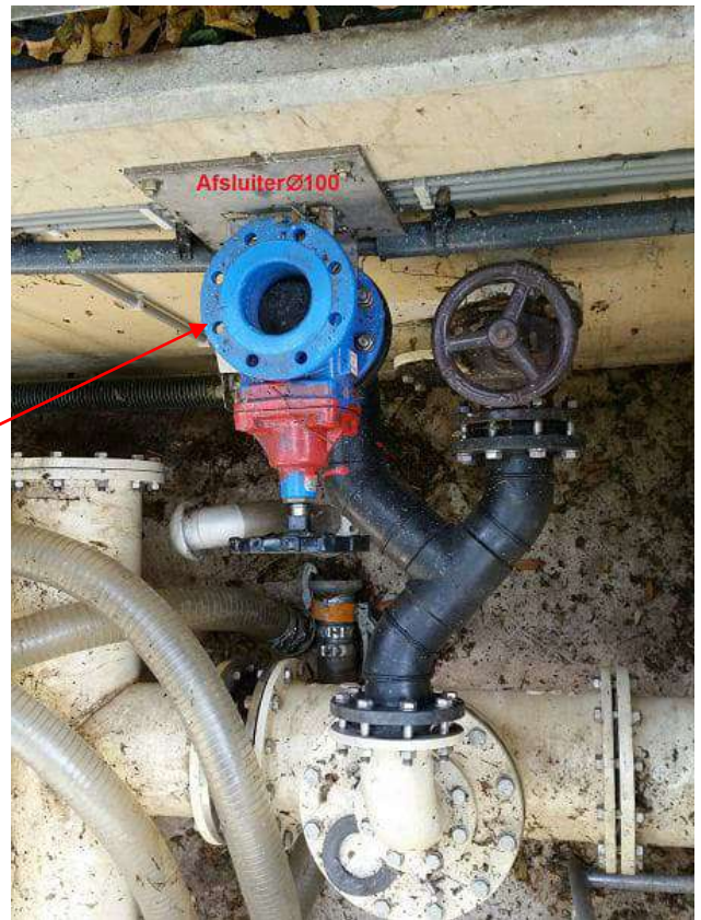
Figuur 38: Arcen detailfoto afsluiter 100 in droge kelder
